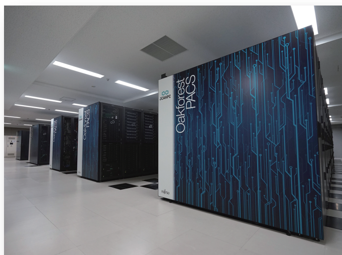
スーパーコンピュータ FUJITSU PRIMERGY CX600 M1/CX1640 M1 (Oakforest-PACS)
